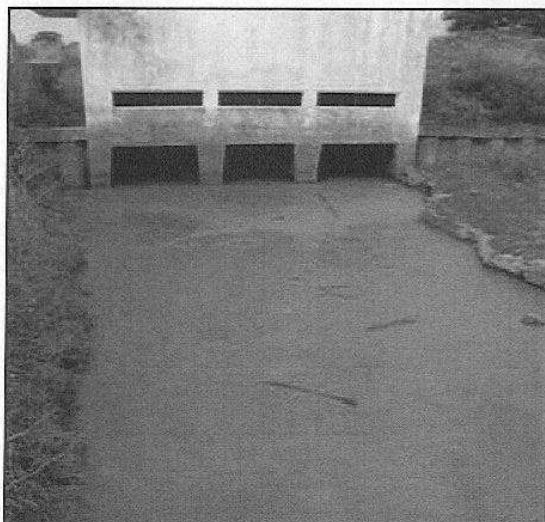
Le Treytis au niveau de la station de pompage avec interruption de la continuité écologique
